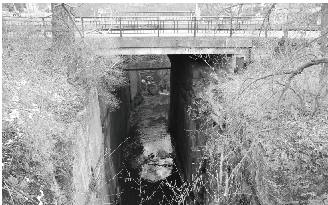
Fig. 12. Bridge over the Novozámecký gap in the village of Zahrádky (source: VMG archive).
