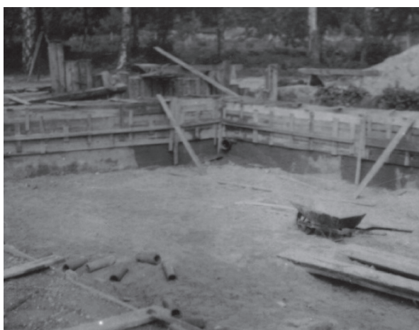
Fot. 7. Budowa basenu w parku Lubuskiego Ośrodka Rehabilitacyjno-Ortopedycznego w Świebodzinie Photo 7. Construction of the pool in the park of the Lubuskie Rehabilitation – Orthopaedic Centre in Świebodzin
